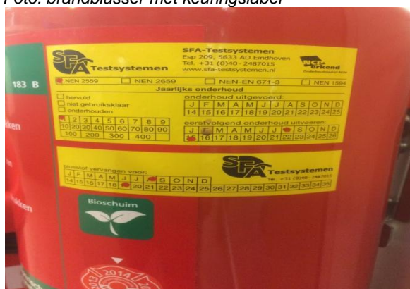
Foto: brandblusser met keuringslabel
